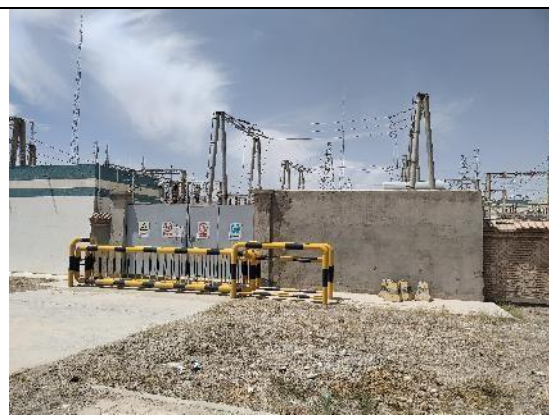
工业园区 110kv 变电站
