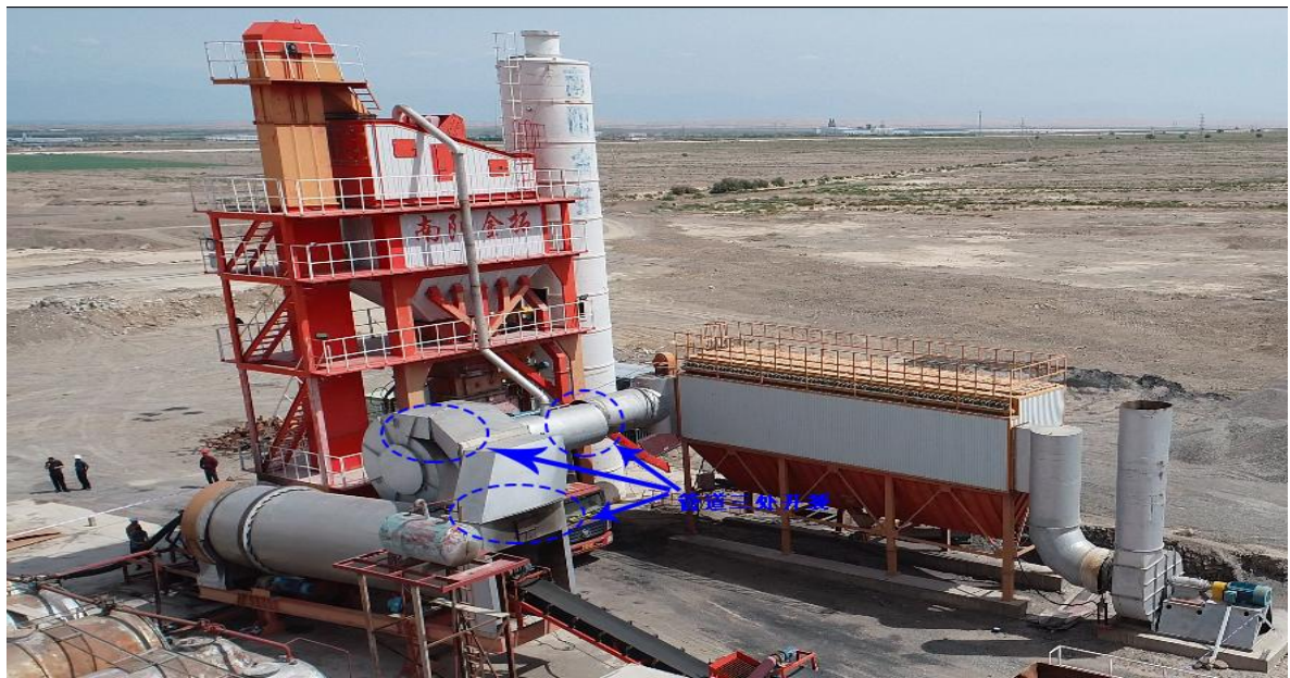
图 5 设备管道开裂示意图
