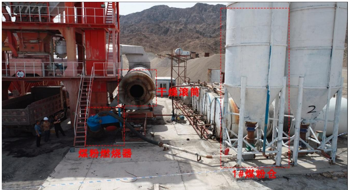
图 4 事故现场部位图
